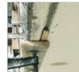
Betonbeschäden an einer Balkonplatte durch zu geringe Betonüberdeckung. Die abgebildete Instandsetzung durch Reprofilierung der Wassernase mittels Einlegen einer Dreikantleiste erhält die Schwachstellen und wird keinen langfristigen Erfolg haben
