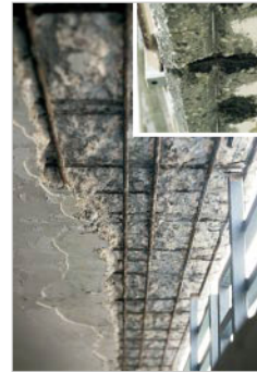
Schäden nach acht Jahren an der Balkonunterseite einer Platte bei völlig fehlender Wassernase beziehungsweise Tropfkante
